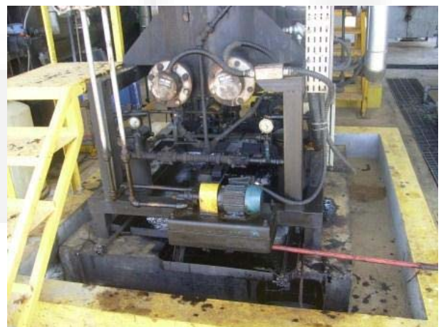
Foto 04. Caldeira a óleo com dique de contenção de vazamentos
