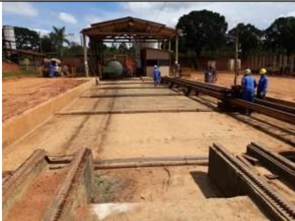
Figura 5. Autoclave e bacia de contenção.
