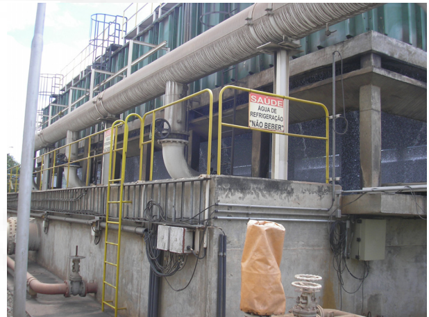
Foto 02. Torre de resfriamento
