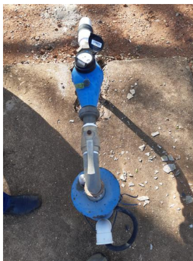
Foto 2. Captação de água (poço tubular)
