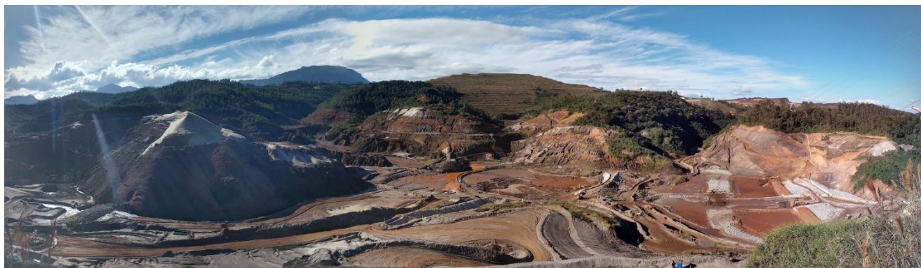
Eixo 1 – Obras dos sistemas de contenção de rejeitos remanescentes de Fundão Cidade Administrativa Presidente Tancredo Neves, Rodovia Papa João Paulo II, nº 4143. Bairro Serra Verde Edifício Minas, 2º andar, 31630-901 - Belo Horizonte – MG Telefone: 3916-9293
