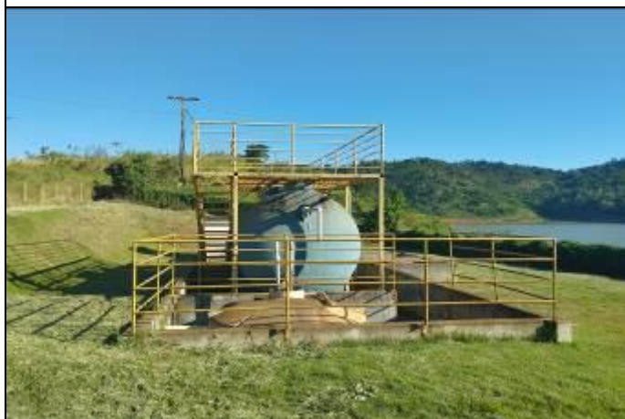
Foto 17: Estação de Tratamento de Efluente 1
