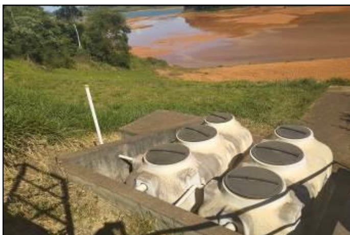
Foto 11: Estação de Tratamento de Efluente 2
