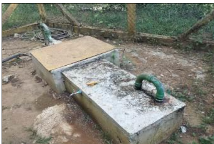
Foto 15: Poço tubular profundo
