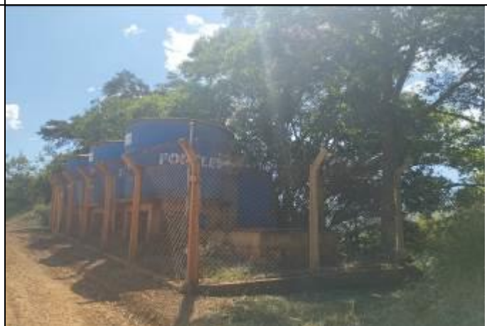
Foto 10: Tanques de armazenamento de água do poço tubular
