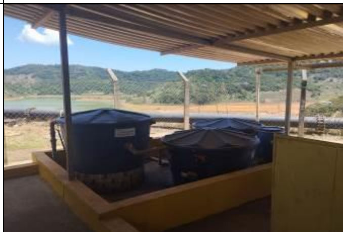
Foto 6: Depósito de óleo industrial e caixa são
