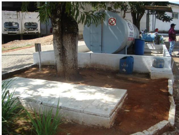
Foto 2: Caixa SAO da área de abastecimento.
