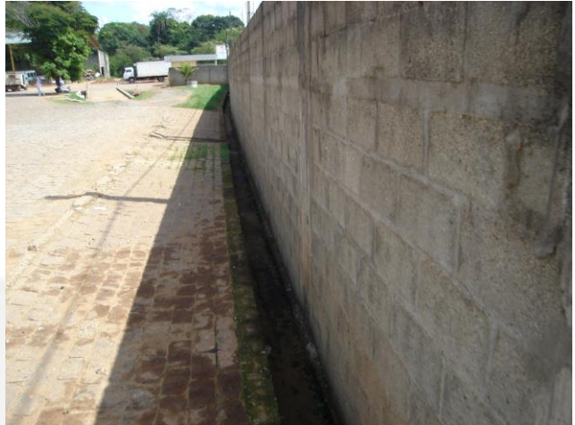
Foto 6: Sistema de drenagem pluvial.
