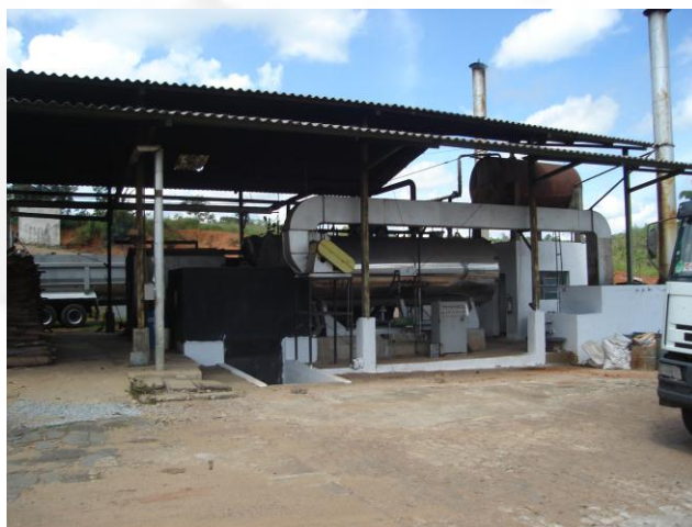
Foto 4: Vista da caldeira.
