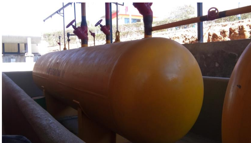
Fotos 3: Reservatório de amônia
