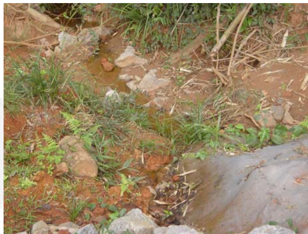
Foto 02. Dreno de fundo
