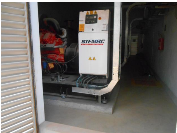
Foto 09. Geradores de energia
