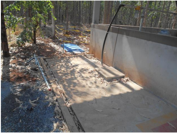
Foto 11. Canaletas e caixa SAO – área de abastecimento
