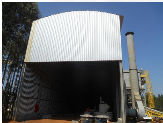
Foto 04. Área de recebimento do coque de petróleo e carvão vegetal - Chaminé
