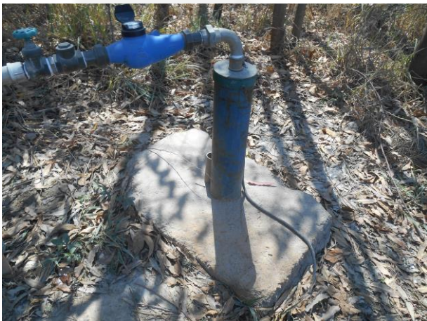
Foto 13. Poço de captação de água
