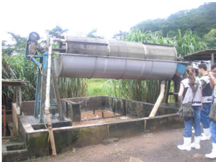
Foto 5. Sistema de Tratamento Primário de Efluentes
