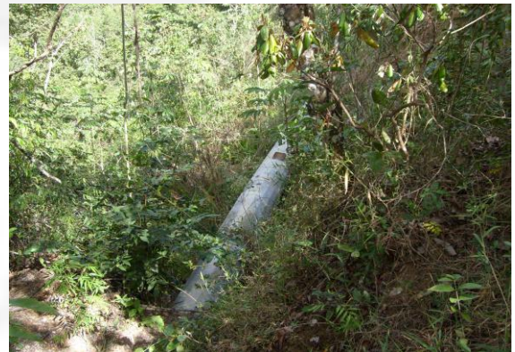
- Tubulação captação de água.
