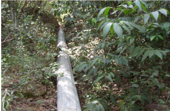
- Tubulação captação d'água
