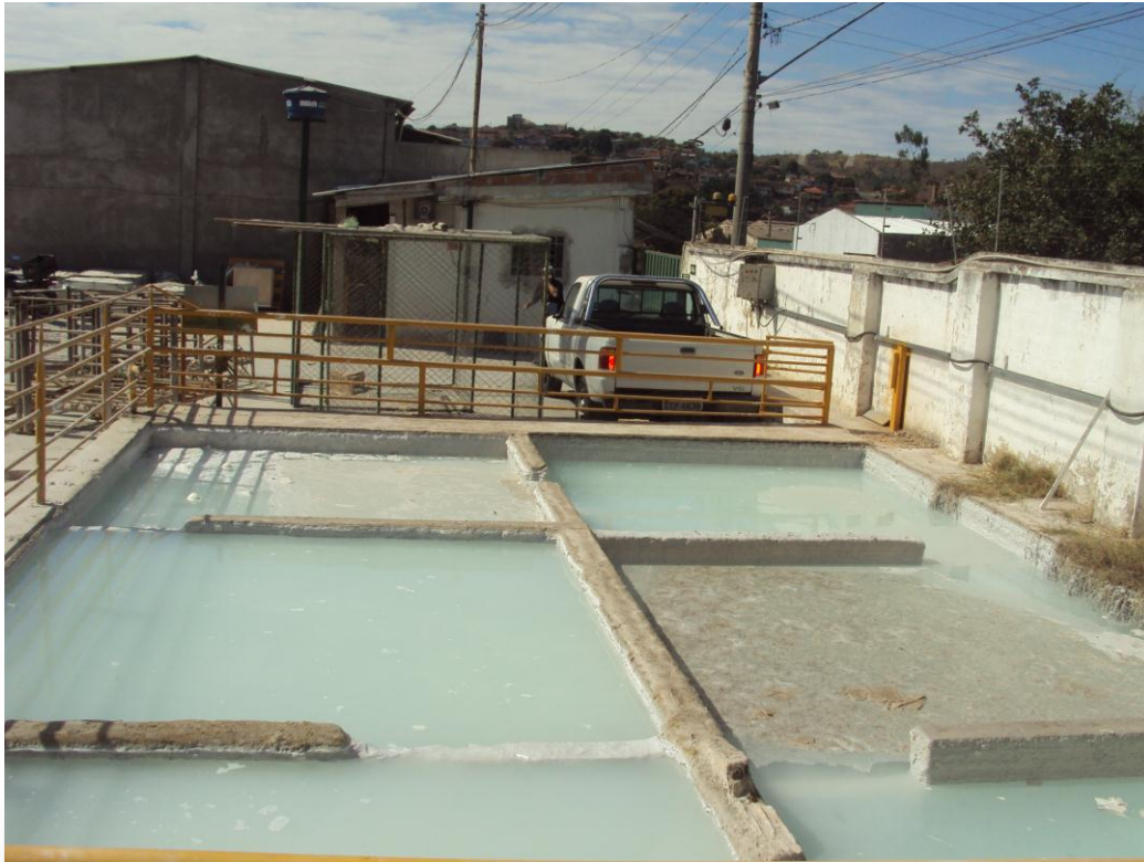
Figura 2. Tanques de sedimentação
