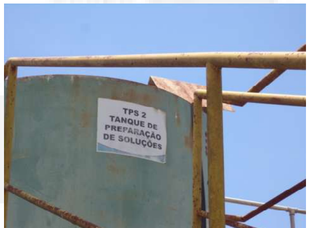
Figura 10. Estação de tratamento de efluentes/esgoto.
