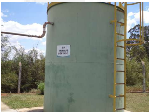
Figura 09. Estação de tratamento de efluentes/esgoto.
