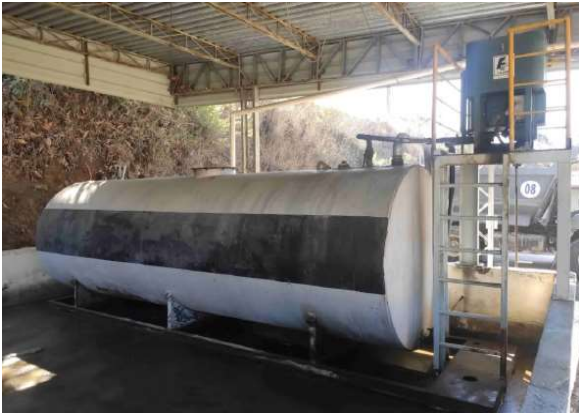
Interior da bacia de contenção (Fonte: RTS)
