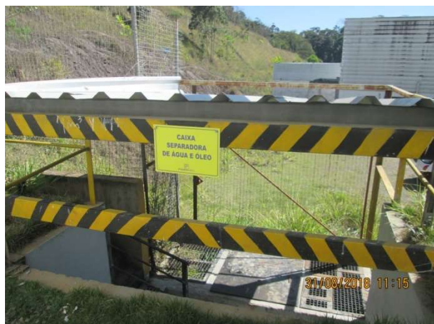
Caixa Separadora de Água e Óleo (SAO)
