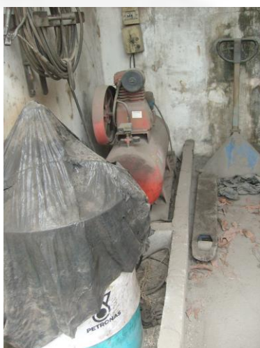
Foto 9: Compressor de ar.
