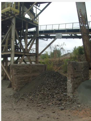
Foto 7: Baía de resíduo metálico.
