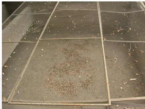
Foto 6: Caixa de sedimentação para água pluvial.
