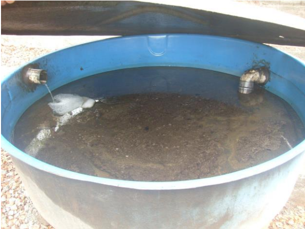
Foto 11: Caixa de SAO.
