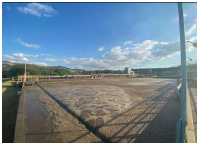
FOTO 3 – Tanque de aeração (reator).
