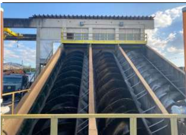
FOTO 5 – Elevatória de lodo.
