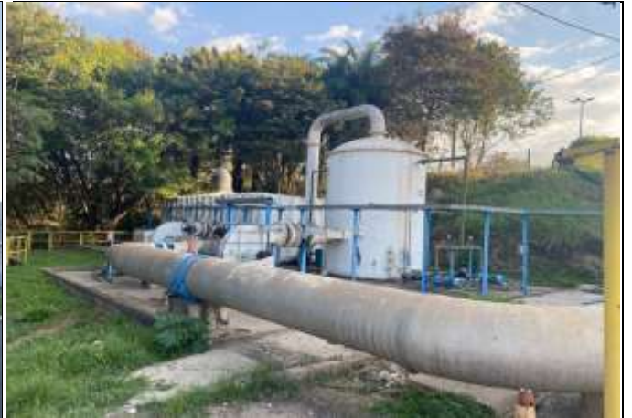
FOTO 10 – Tratamento de odores.
