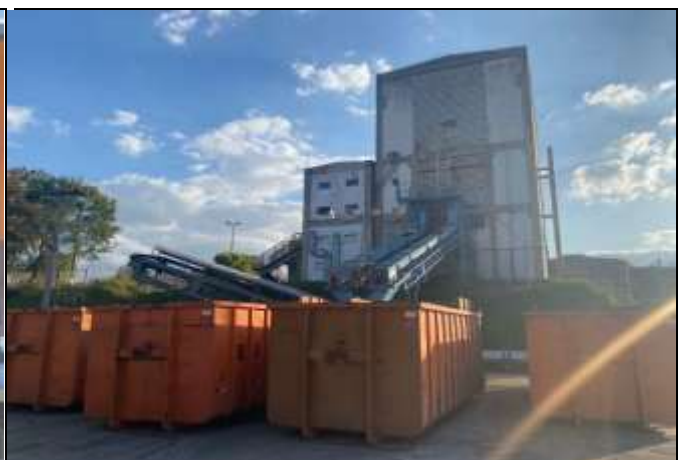
FOTO 6 – Desidratação de lodo.
