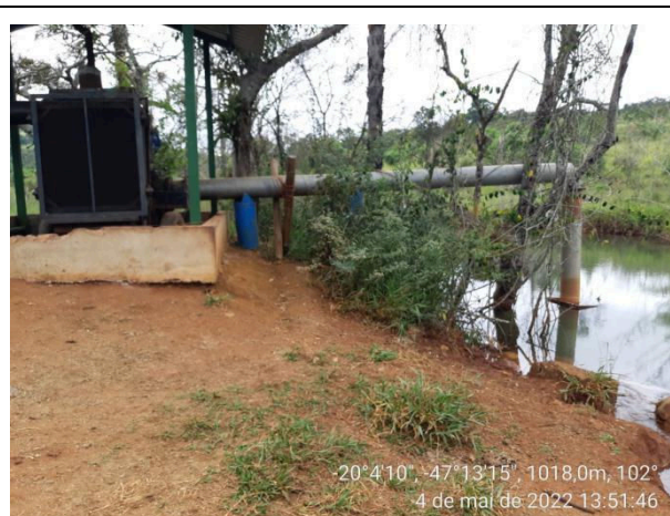
Foto 6. Captação de água superficial
