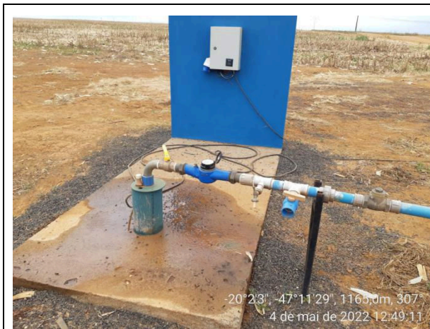
Foto 5. Captação de água subterrânea
