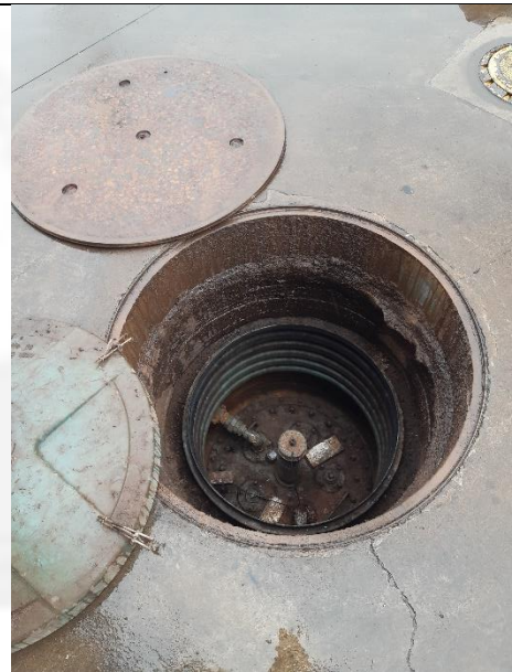
Foto 04. Boca de visita com sump
