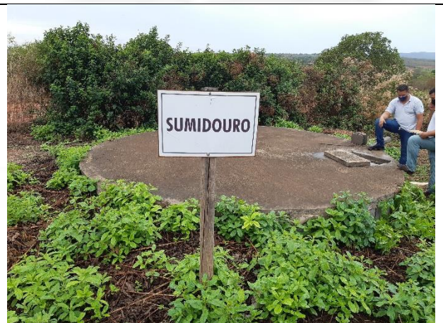
Foto 12. Sumidouro para destinação final dos efluentes tratados
