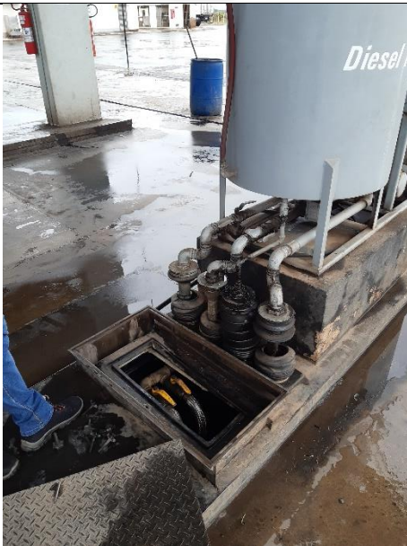
Foto 05. Filtro de diesel com sump
