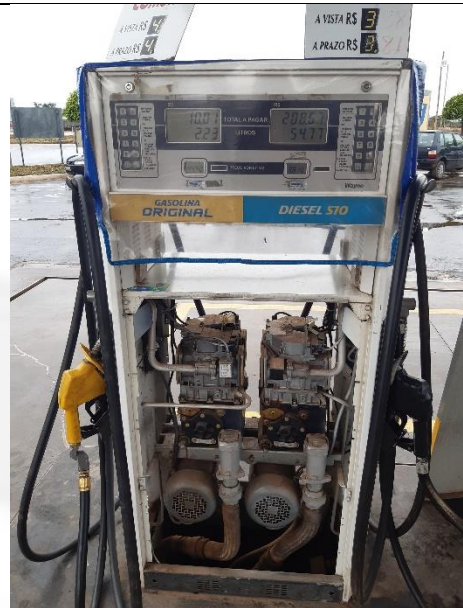
Foto 06. Bomba de abastecimento com check-valve e sump
