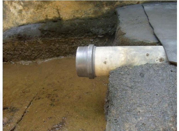
Foto 28: Tamponamento da canalização da entrada da lâmina d'água.
