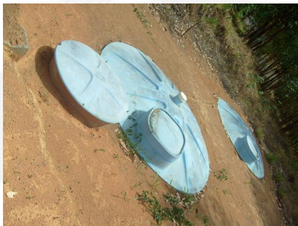
Foto 16: Sistema de tratamento de efluente líquido industrial.
