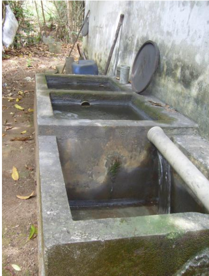
Foto 23: Caixa de sedimentação do galpão 23.
