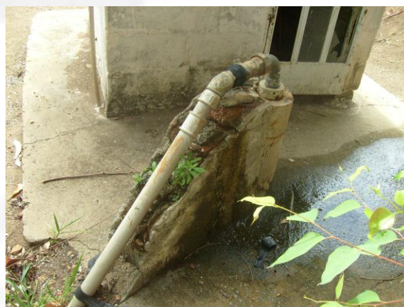
Foto 8: Captação em poço tubular.
