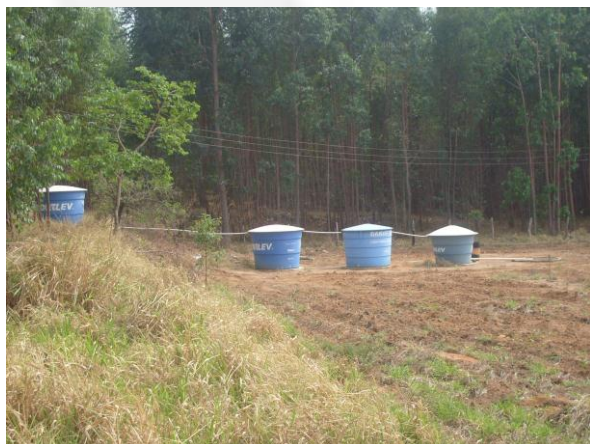
Foto 15: Sistema de tratamento de efluente líquido industrial.
