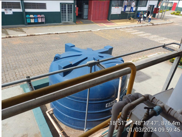
Foto 05: Tanque de acumulação de efluentes tratados (ETEI)
