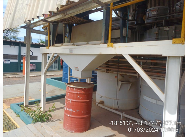
Foto 06: Prensa e tambor de acumulação do lodo seco (ETEI)
