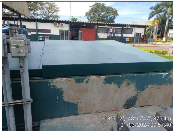
Foto 01: Tanque de secagem da borra de tinta (ETEI)
