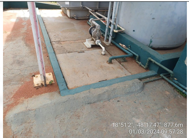
Foto 02: Caixa de sedimentação e acumulação (ETEI)
