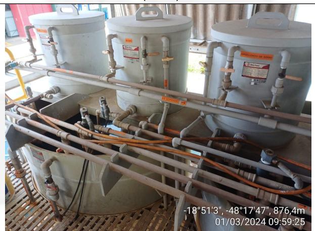
Foto 04: Reatores de tratamento (ETEI)
