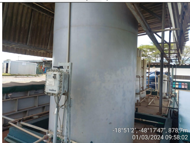
Foto 03: Tanque de acumulação de efluentes brutos (ETEI)
