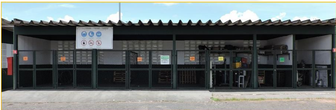
Figura 05: Central de resíduos sólidos - baias de armazenamento temporário de resíduos classes I e II Fonte: RCA (p. 31)
