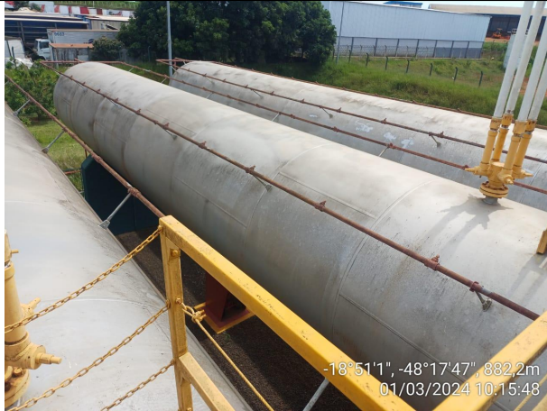
-18°51'1", -48°17'47", 882,2m 01/03/2024 10:15:48 Foto 11: Reservatórios de armazenamento P-60.000
