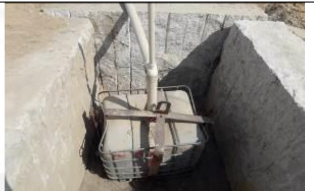
Foto 6: Fossa séptica do banheiro móvel.
