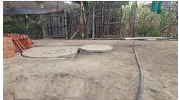
Foto 4: Fossa séptica – alojamento
