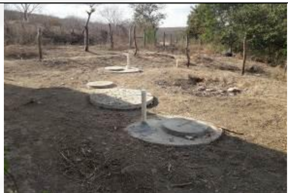
Foto 10: Fossa séptica – alojamento.
