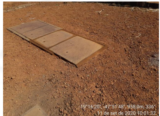
Figura 2. Lançamento do efluente da caixa separadora de água e óleo (fazenda Boa Esperança) em 11/09/2020.
