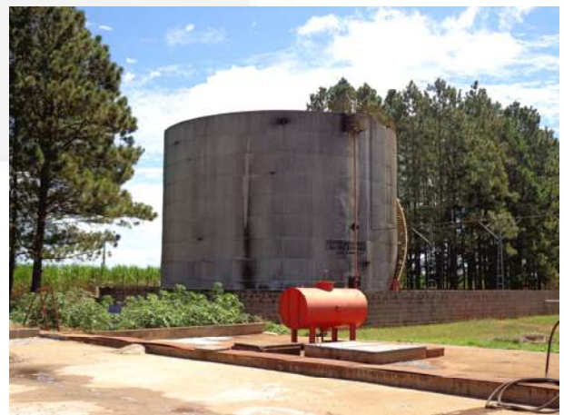
Foto 10. Tanques de armazenamento
