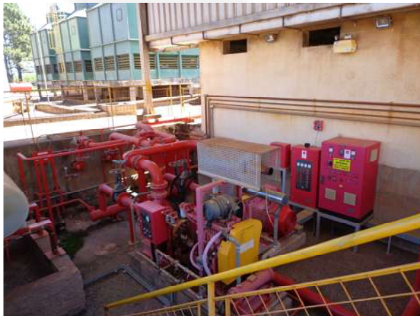
Foto 13. Sistema de combate a incêndio
