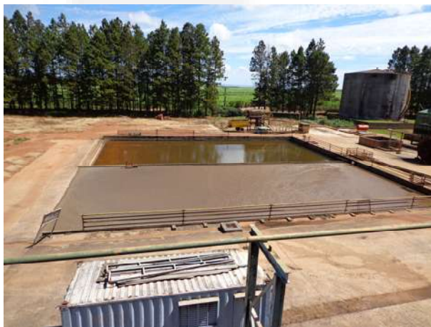
Foto 07. Tanques de sedimentação
