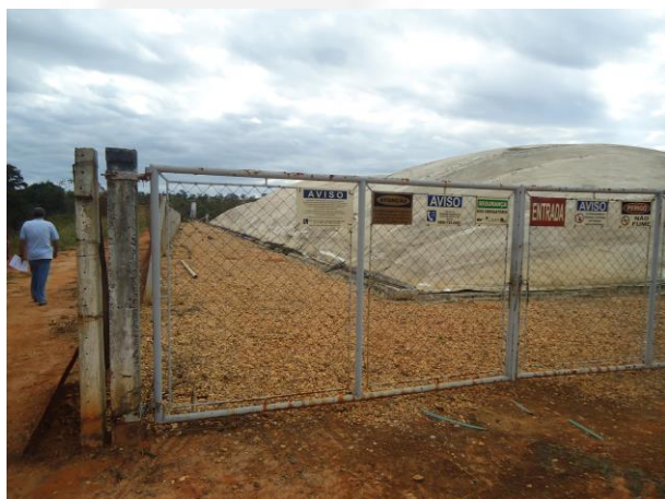
Foto 10. Biodigestor antes da manutenção.
