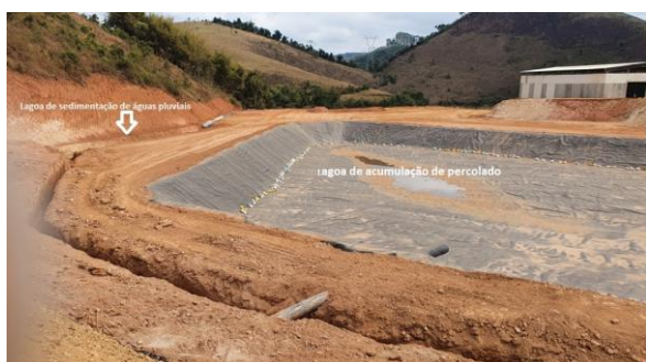
Lagoa de sedimentação de águas pluviais e lagoa de acumulação de percolato do aterro de resíduos de Classe II.
