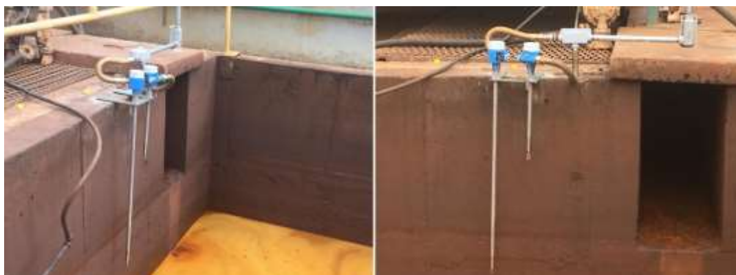
Figura 3 - Chaves de Nível da Caixa de Contenção. (Fonte: Documento protocolo SIAM nº0265777/2019).
