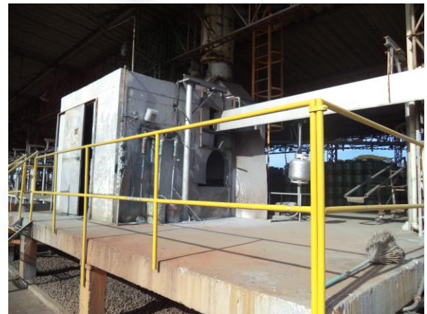
Foto 02. Cabine de pintura
