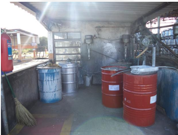
Foto 03. Armazenamento de tinta em contenção
