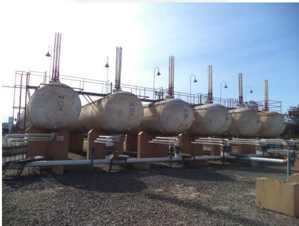
Foto 01. Tanques de armazenamento de GLP.
