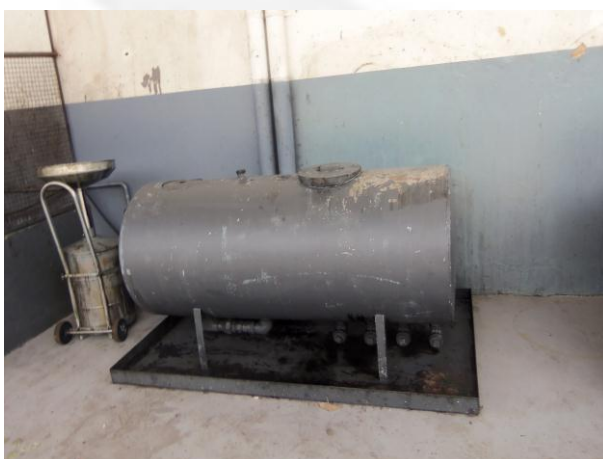
Figura 10- Reservatório de óleo usado
