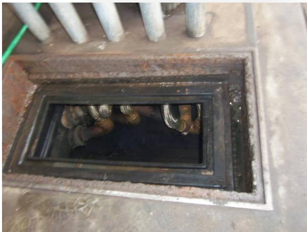
Figura 8- Sump do filtro de Diesel
