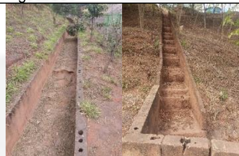
Figura 16. Sistema de controle de drenagem pluvial
