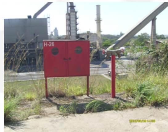
Foto 07. Equipamentos de combate a incêndios.
