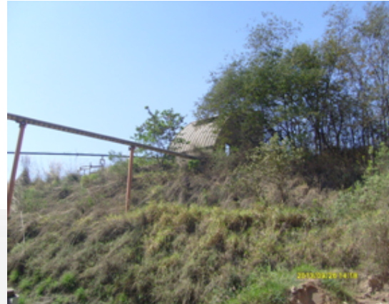
Foto 03. Dutos de transporte do resíduo líquido para os tanques de armazenamento.
