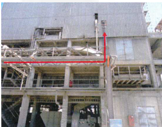
Foto 06. Tubulação de transporte do resíduo até o forno.
