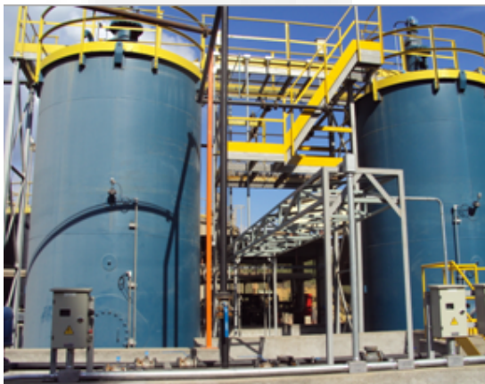
Foto 04. Tanques de armazenamento do resíduo líquido.
