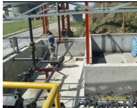
Foto 05. Bombas para o transporte do resíduo líquido até o forno, com bacia de contenção.
