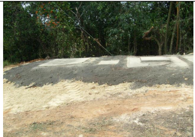
Foto 06: Sistema de tratamento de efluentes sanitários
