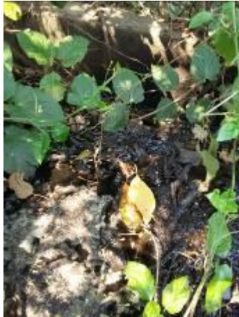
Foto 11. Ponto com comunicação de efluente bruto e rede pluvial, com extravasamento para solo (antes da adequação).
