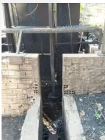
Foto 09. Contenção da elevatória com vazamento (antes da adequação)
