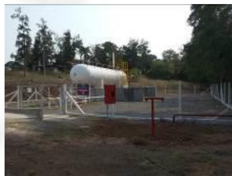
Foto 02. Base de armazenamento de GLP.
