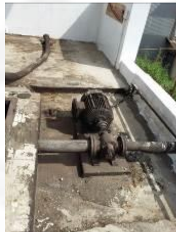
Foto 14. Área de recebimento de óleo BPF (após adequação).
