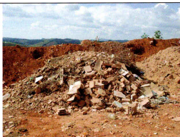
Foto 03: Disposição de Resíduos da Construção Civil (RCC) no local.
