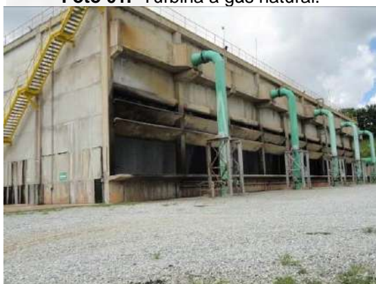
Foto 03. Torre de resfriamento.
