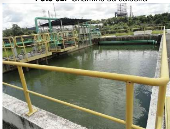
Foto 04. Tanque de equalização.
