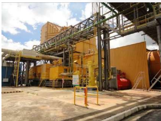
Foto 01. Turbina a gás natural.
