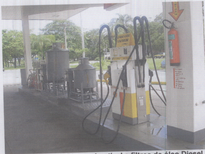
Foto 01 – Bomba de combustível e filtros de óleo Diesel.
