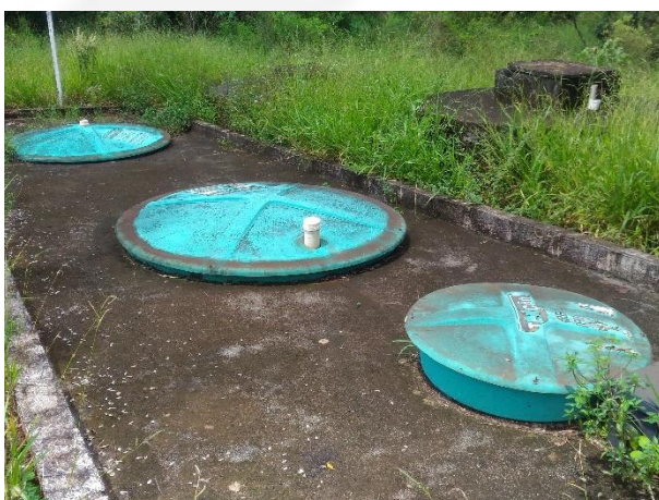
FOTO 3 – Fossa, filtro e sumidouro.
