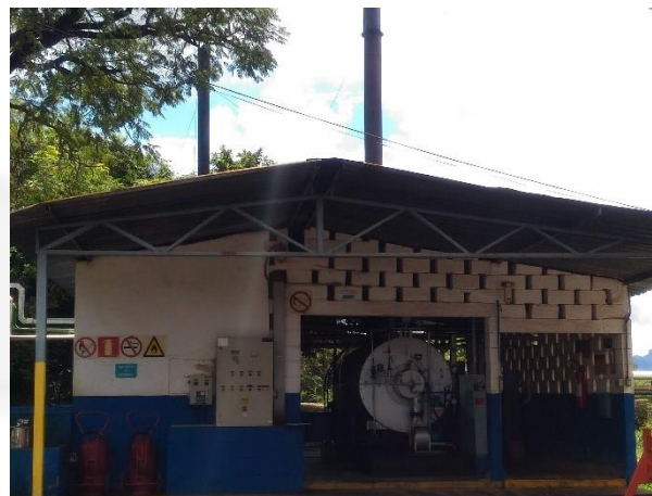
FOTO 2 – Setor das caldeiras a óleo BPF.
