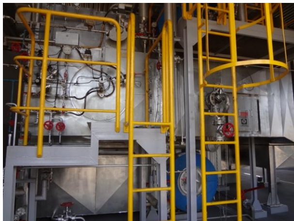
Foto 01. Caldeira a óleo utilizada para geração de vapor.
