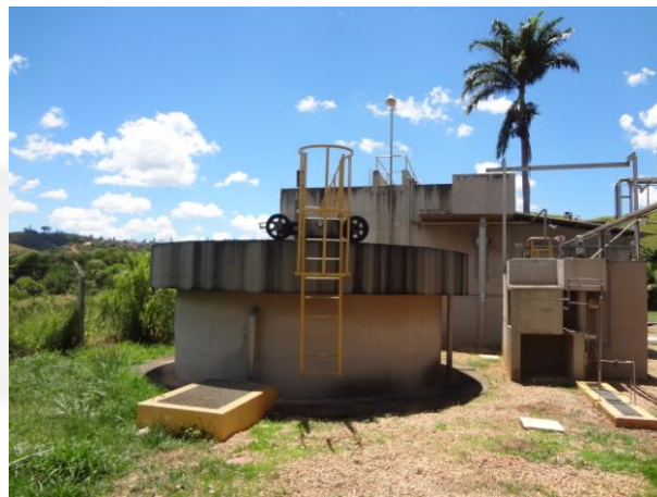
Foto 02. Estação de Tratamento de Efluentes - ETE.
