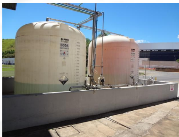
Foto 04. Local de armazenagem da Soda Caustica e Ácido Sulfúrico, com bacia de contenção.
