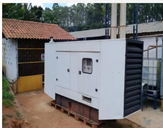
Foto 05. Gerador de energia.
