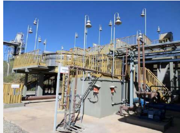
Foto 02. Estação de tratamento de efluentes.
