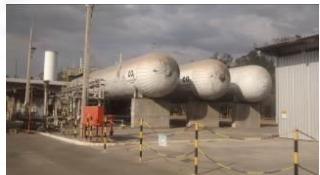
Foto 8 - Tanques de CO 2 Líquido
