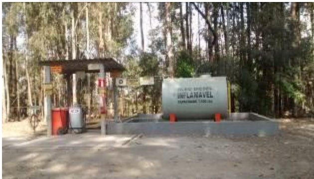
Foto 7 - Tanque de combustível
