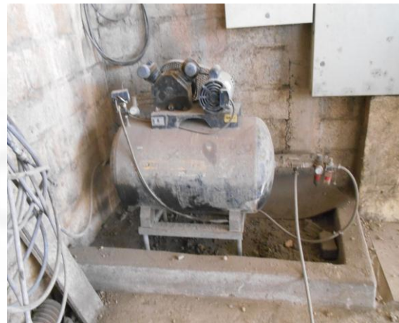
Foto 8: Compressor com bacia de contenção.
