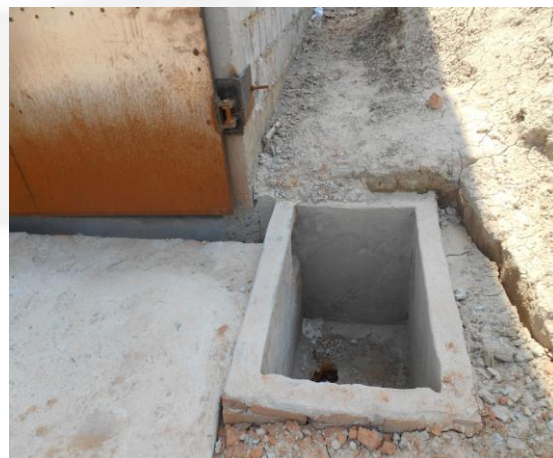
Foto 4: Caixa de sedimentação do depósito.
