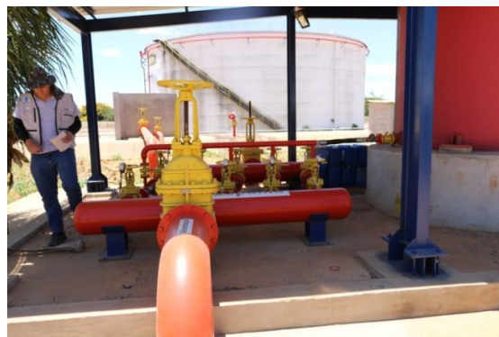
Foto 06. Tanque já existente (ao fundo), com sistema de combate a incêndio.
