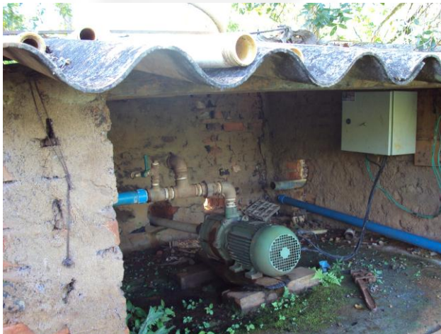
Foto 07: captação em água subterrânea
