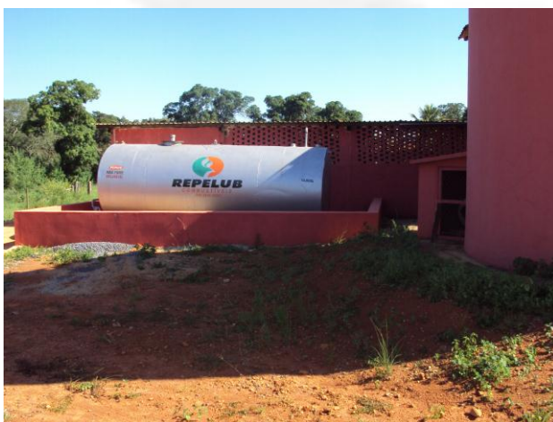
Foto 09: tanque de combustível implantado
