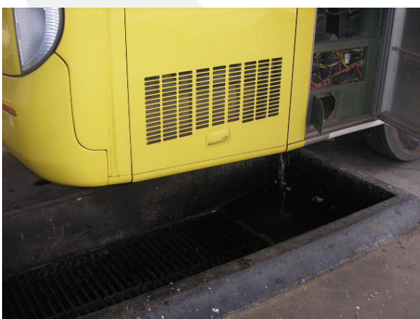
Foto 03 e 04: Descarga de efluentes sanitários.
