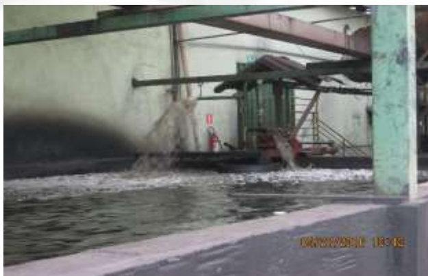
Foto 3 – Estação de Tratamento de Efluente Industrial
