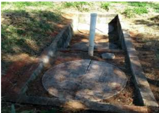
Foto 01: Fossa1 - Sistema Fossa Séptica/ Filtro anaeróbio
