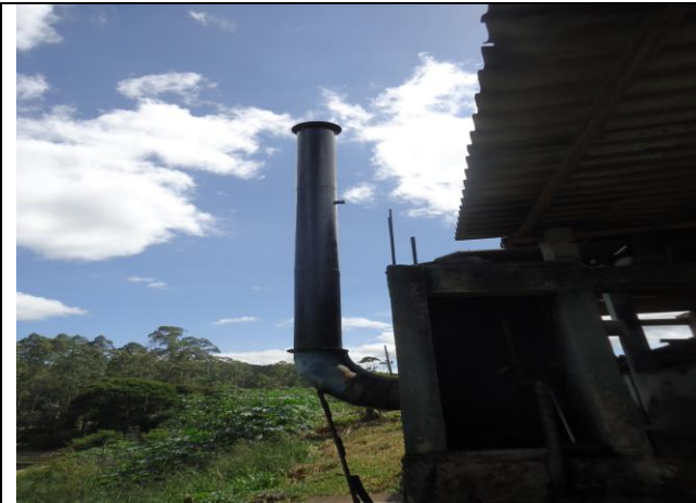
Foto 01. Sistema de controle da emissão atmosférica.
