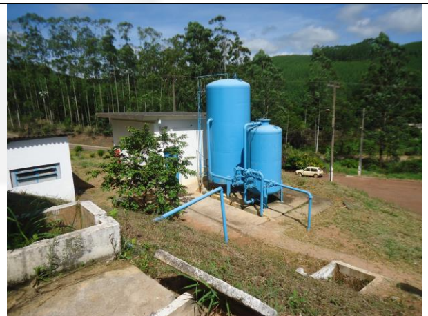
Foto 06. Reservatório de água tratada
