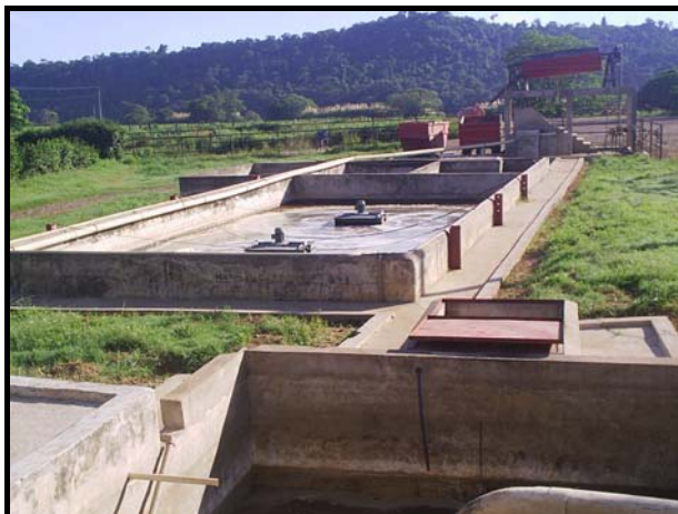
Foto 01. Estação de tratamento de esgoto do matadouro Rio Doce.
