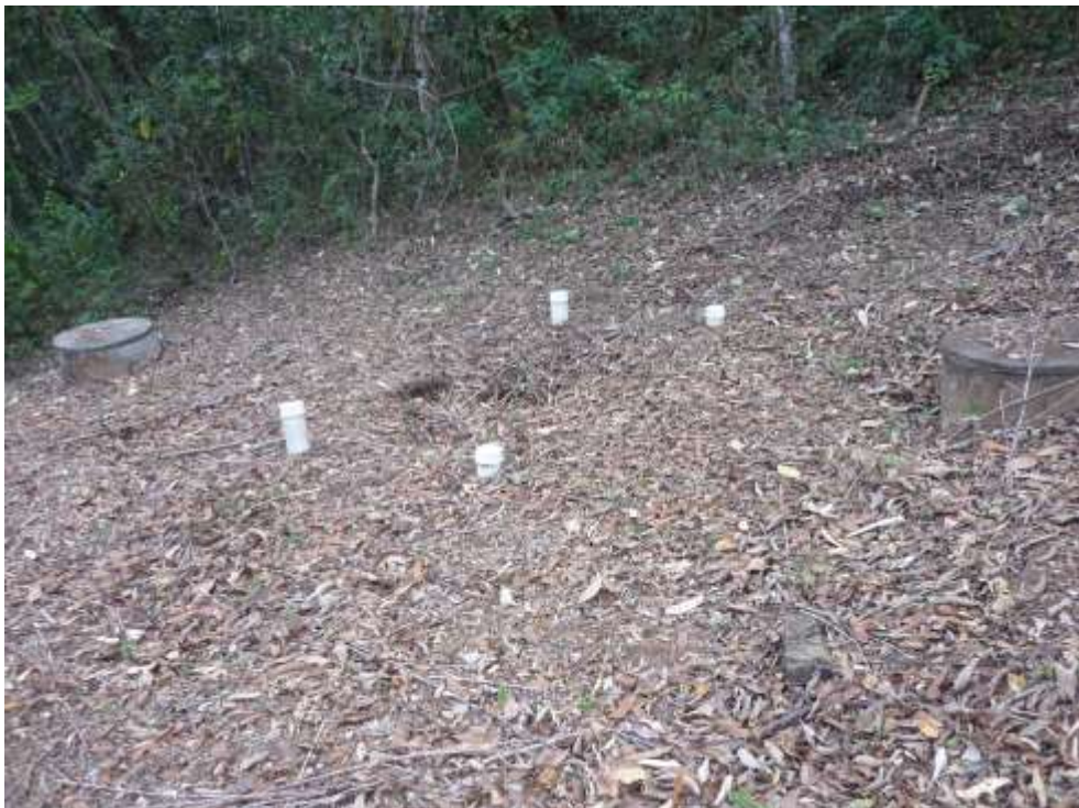
Figura 47: Sistema instalado de tratamento dos esgotos
