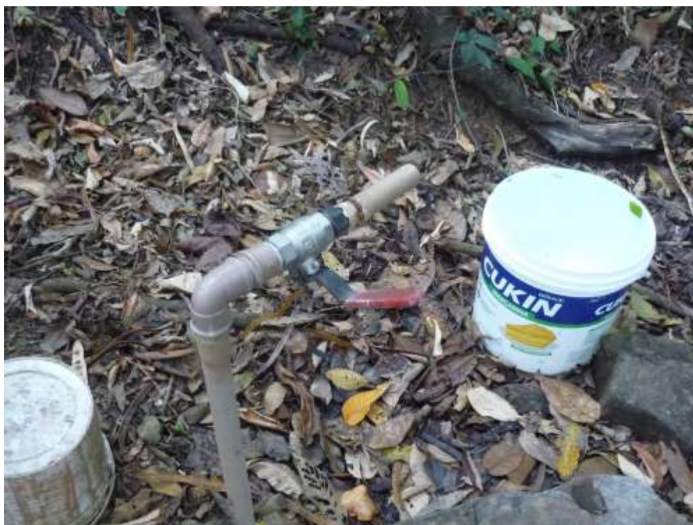
Figura 44: Registro de água captada em cisterna outorgada
