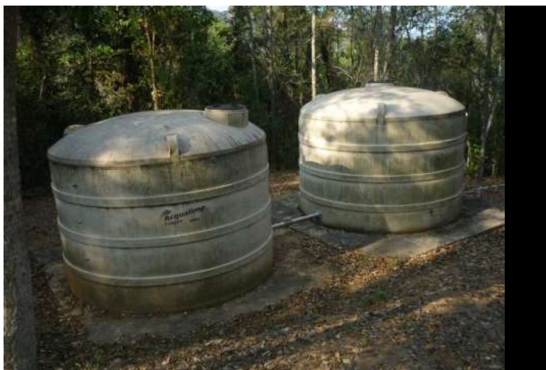
Figura 45: Caixas d'água com capacidade unitária de 15 m 3
