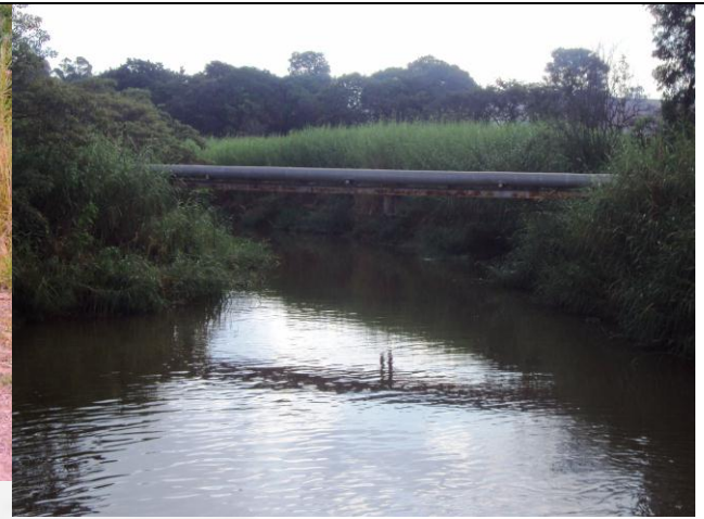
Foto 9. Tubulação de gás sobre o rio São João.
