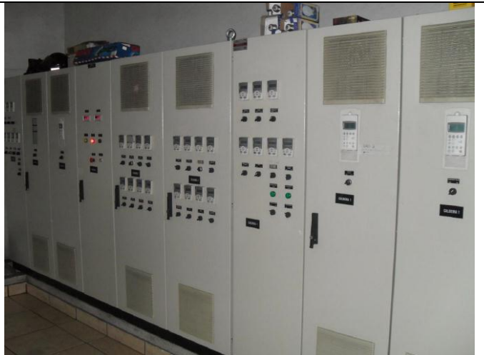
Foto 2. Sala de comando informatizada.
